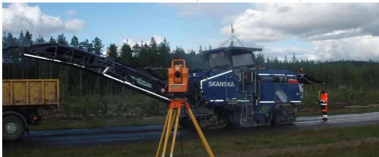
Obr.13: Frézovací práce dálkově řízené totální stanicí. Terč je umístěn v dostatečné výšce nad strojem a propojený s řídicím počítačem.
