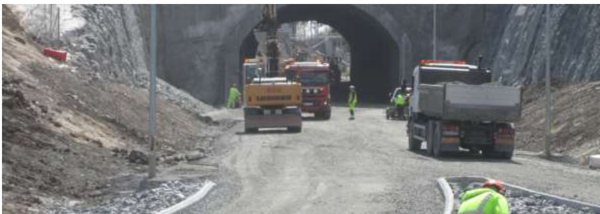
Obr. 2: tunel V76 – Norrtälje - Švédsko (zdroj: EHRAB V76 Förbi Norrtälje Sweden – ilustrační snímek)
